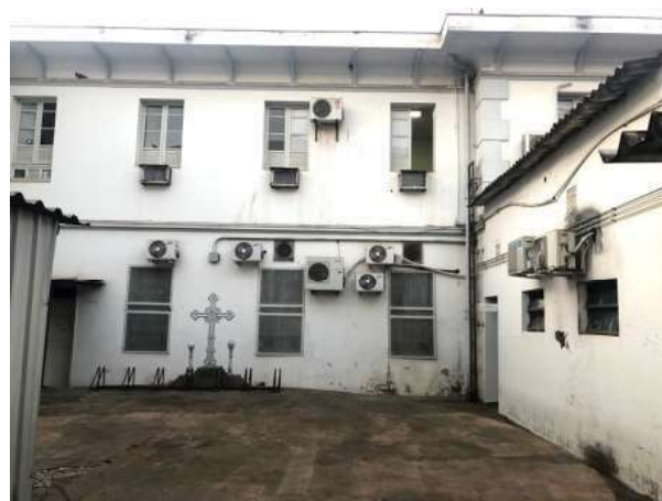
Figuras 21 e 22 – Em ambas as fotos observam-se a presença de anexos contíguos ao edifício, assim como a proliferação de ares condicionados, bem como a presença de mofo e manchas de umidade nas paredes externas. Fonte: LOPES, 2018.
